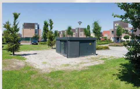
Buurtbatterij aangelegd door netbeheerder.
