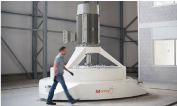
Figuur 16 – KINEXT Vliegwiel van S4 Energy BV. Bron: S4 Energy BV
