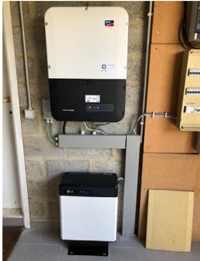
Figuur 1 – Omvormer voor zonnepanelen (boven) en 10 kWh thuisbatterij (onder)
