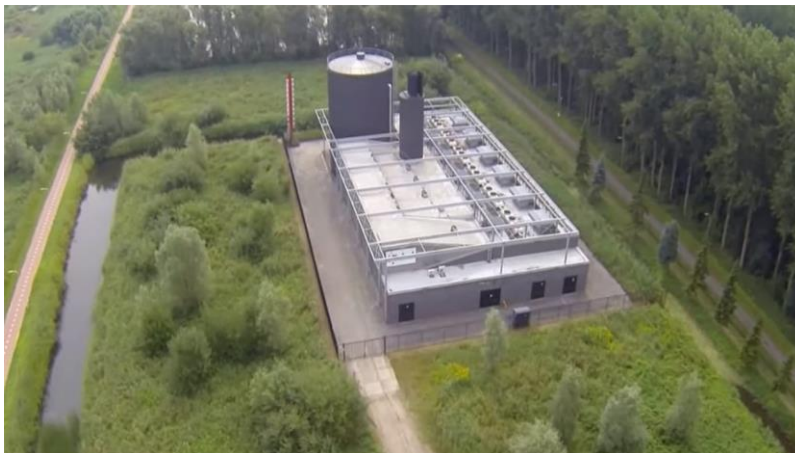
Figuur 20 - Elektrodeboiler Ypenburg (Eneco, s.d.)
