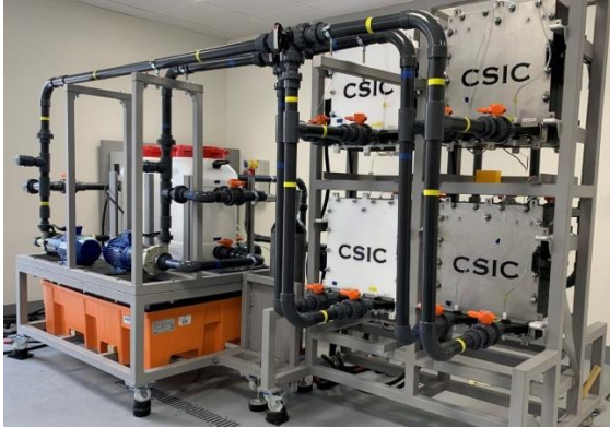
Figuur 5. Vanadium flow batterij demonstratie opstelling 20 kWh
