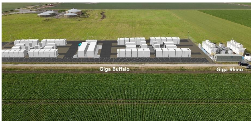
Figuur 4. Grootschalig lithium-ion batterij opstelling bij een windpark (Giga Buffalo = 48 MWh, Giga Rhino = 7 MWh)
