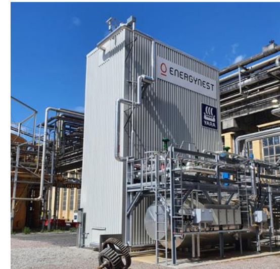
Thermische opslagbatterij, Energynest Noorwegen
