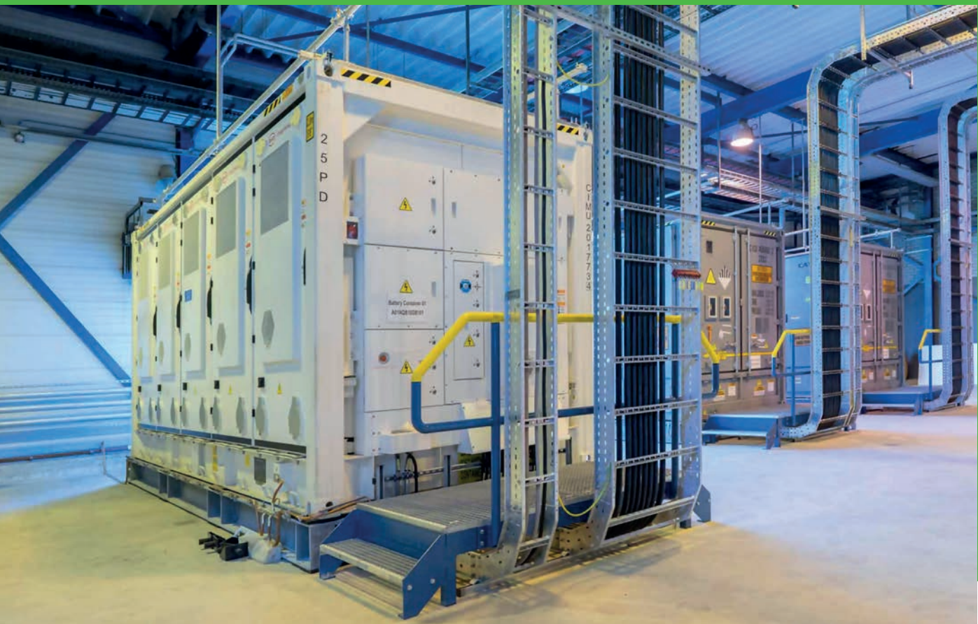
Batterijsysteem van RWE in Moerdijk. © Energy Storage NL
